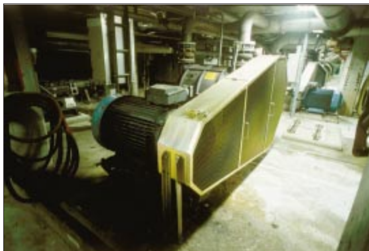
Underhållsarbetet underlättas också av helt nya remskydd. Remmar och skivor är lätta att kontrollera och komma åt, genom lätt öppnade dörrar och grindar.
